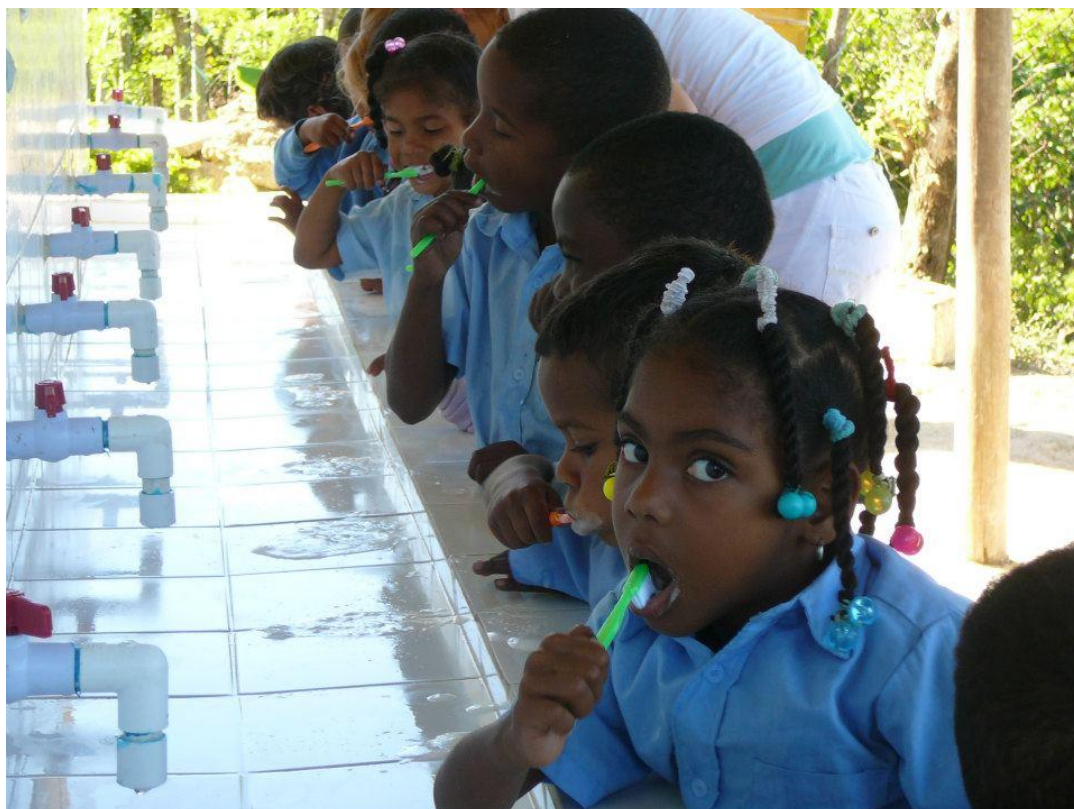
Poetsinstallatie, duurzamer, met kraantjes en tegels
